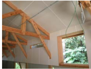
養鶏事業者 鶏舎内天井・壁
